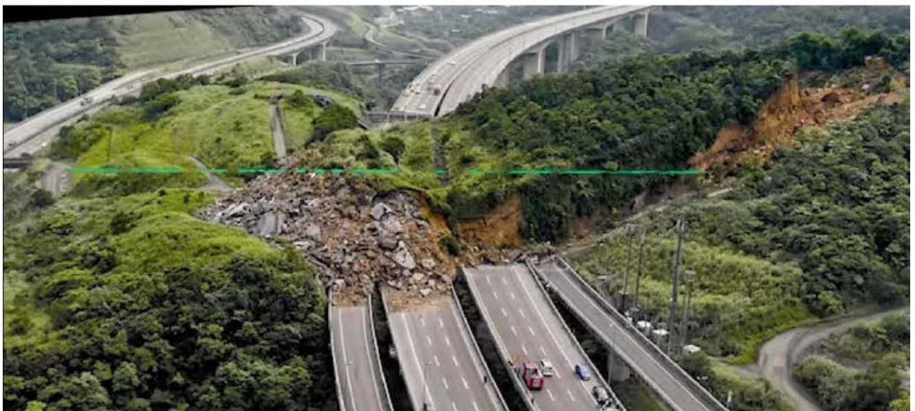
國道3號基隆大埔段順向坡地層滑動
